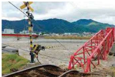
上田電鉄の鉄橋が崩落(上田市)
