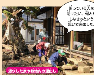
浸水した家や敷地の泥出し
