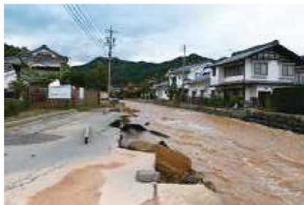
河川の氾濫で道路にも被害が出た(佐久市)
