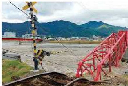
上田電鉄の鉄橋が崩落(上田市)
