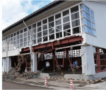
▲決壊現場目の前の体育館は床が流れ柱だけの状態
