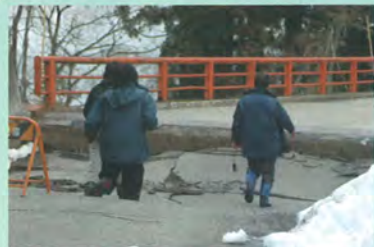
橋が大きく寸断され、通行が困難に ※
