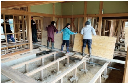
浸水した建物にて、床と壁を剥がし、床下の泥出しをする支援活動。
